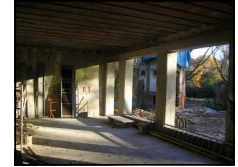
La grange : des travaux en attente...
