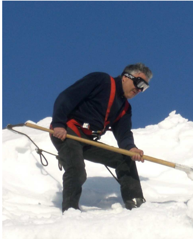
Flagrant délit de travail acharné : Serge décharge le toit du Chabichou, pour lui éviter de céder sous le poids de la neige.
